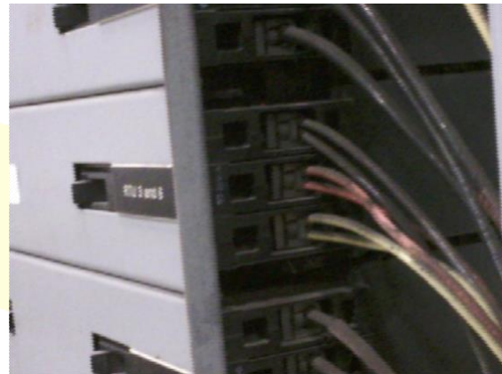
FLIR0005.jpg FLIR E75 78507272
