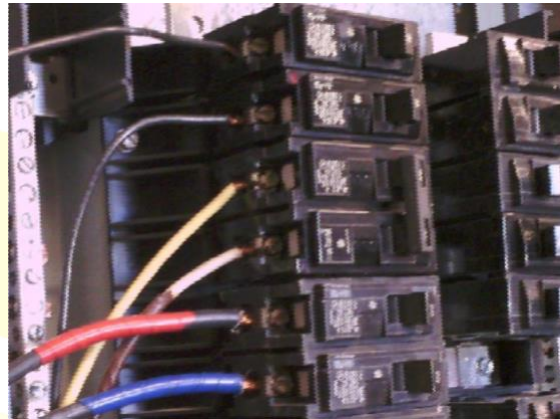
FLIR0027.jpg FLIR E75 78507272
