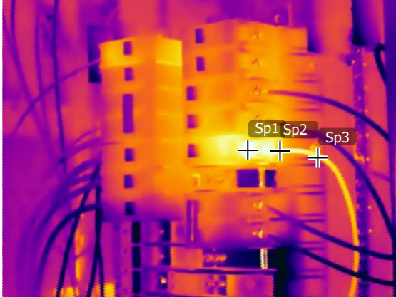
FLIR0025.jpg FLIR E75 78507272
